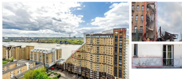
图2 裂缝、空鼓、渗水、脱落等问题
